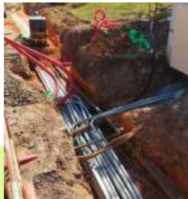
Réseaux secs enterrés
