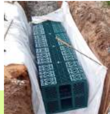
Système de drainage des noues Capacité 280 000 L dans la rue
